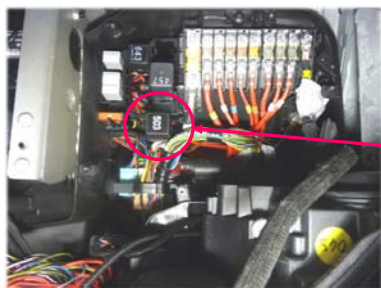
Коммутационный блок в моторном отсеке под АКБ
